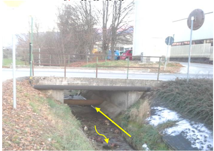
Tubo che riduce la sezione di deflusso
