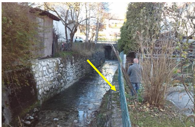
Argine in destra idrografica da riposizionare in quota
